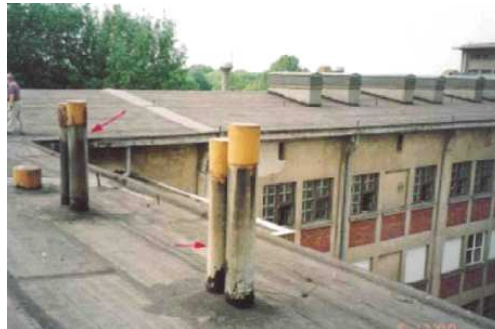
Zdjęcie 6 Instalacja- przewody wentylacji grawitacyjnej w obiekcie przemysłowym wykonana z rur azbestowo-cementowych
